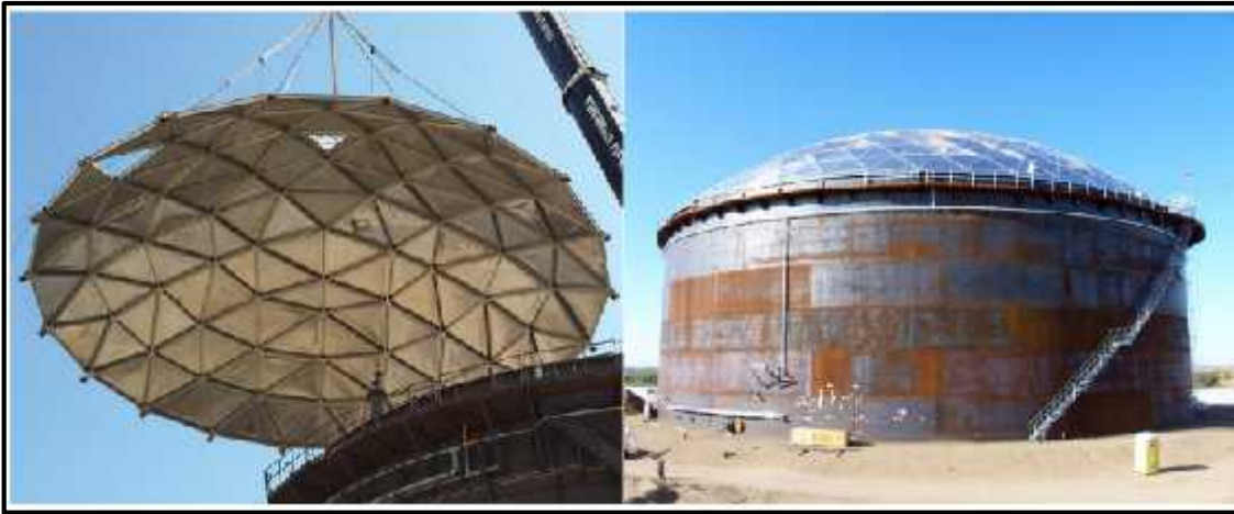
Figura 5. Tanque de almacenaje de techo fijo auto-soportado, tipo domo.
