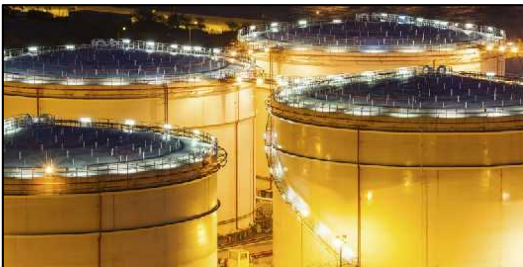
Figura 1. Tanques de almacenamiento.
