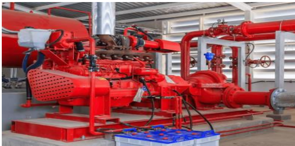
Figura 4: Bombas estacionarias contra incendio
