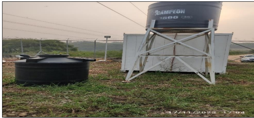
Figura 10: tanques de agua sin unos en el City Gate Monteagudo
