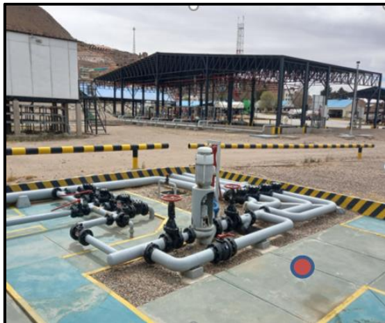
Figura 5: Vista general de Bomba Centrífuga existente en Estación Oruro
