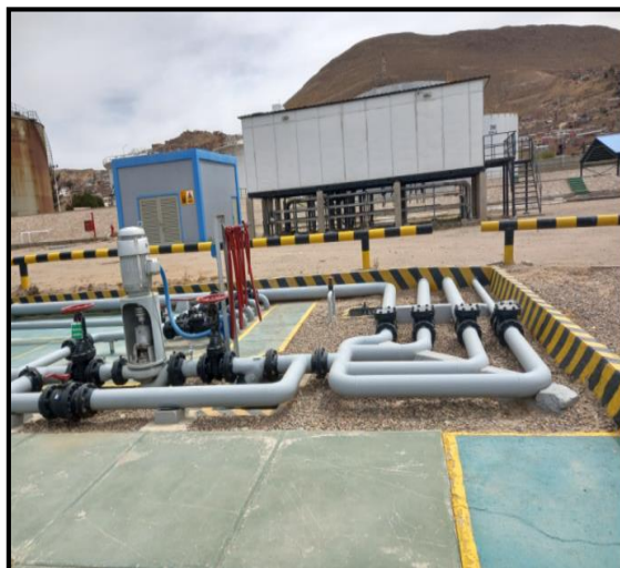
Figura 6: Vista lateral de bomba existente UPB-
