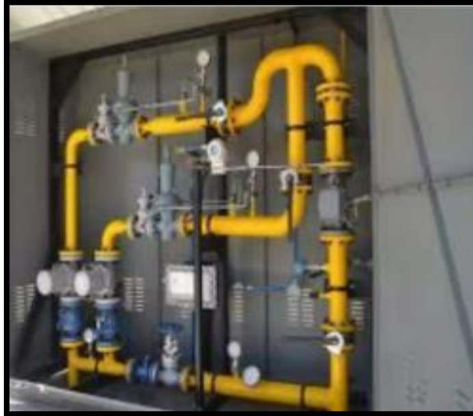
Figura 5: Estación distrital de regulación
