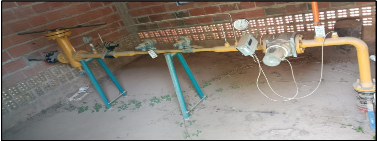
Figura 4: Puente de regulación y medición de gas actual
