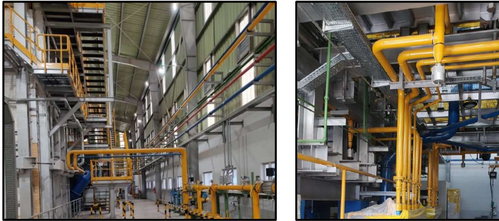
Figura 3. Instalación industrial de tuberías
