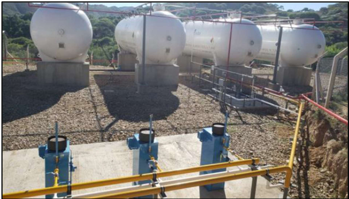
Figura 4. Vista General de Estación GLP
