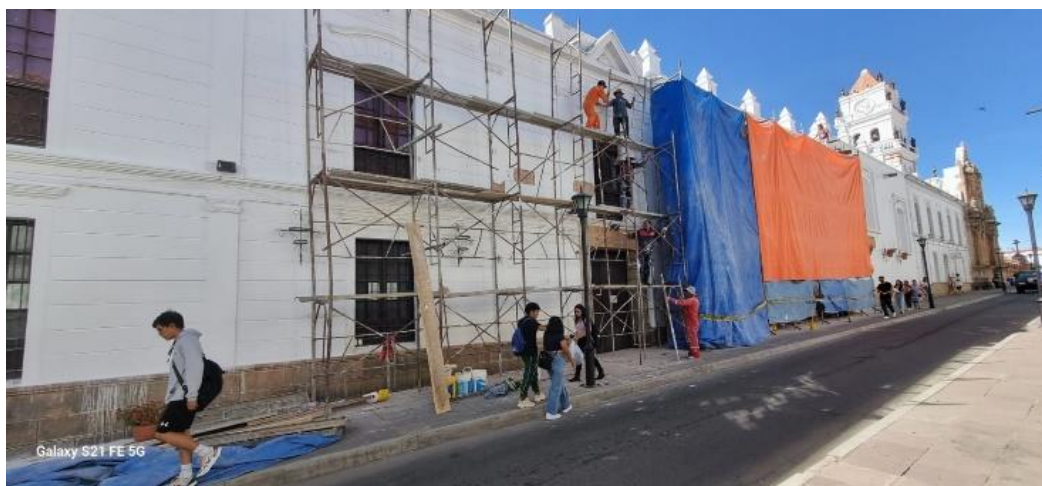
Imagen N°6 Restauración en Fachado por degradación Física - Fuente: Elaboración Propia.
