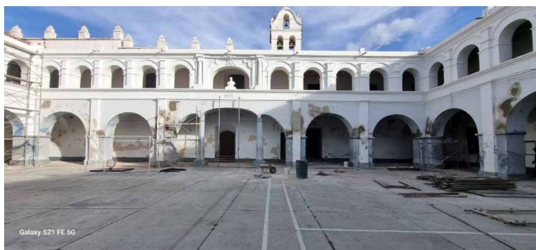
Imagen N°7 degradación Mecánica - Fuente: Elaboración Propia
