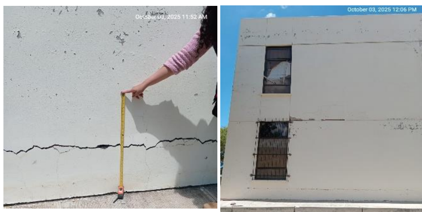
Figura 4.8 a) Deformación con fisuras entre el sobrecimiento encima de la viga de arriostre +0.00 Eje 1, b) Fisuras transversales debido a los asentamientos diferenciales con fisuras en las vigas de los otros niveles (Elaboración propia).
